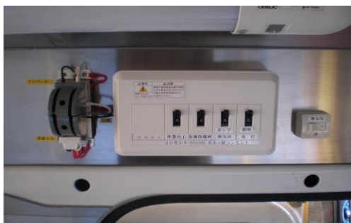
分電盤(配電盤)
