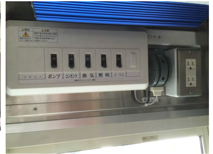
車内ブレーカー
