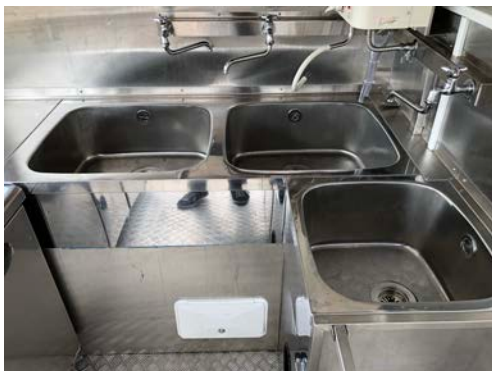
2槽＋手洗いシンク
