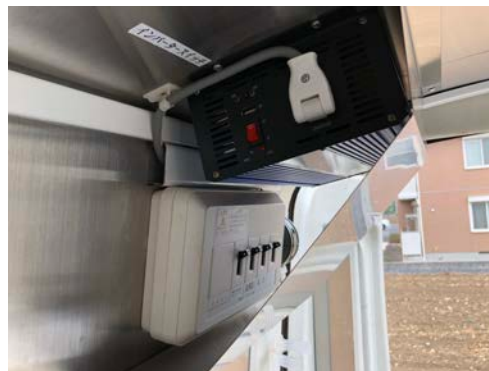
分電盤(配电箱)
