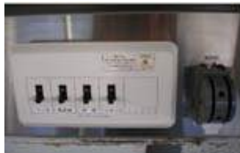
分電盤(配電盤)
