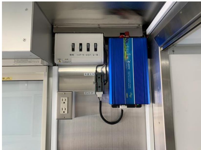
分電盤 インバーター
