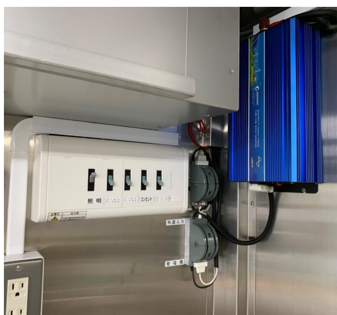
分電盤 インバーター
