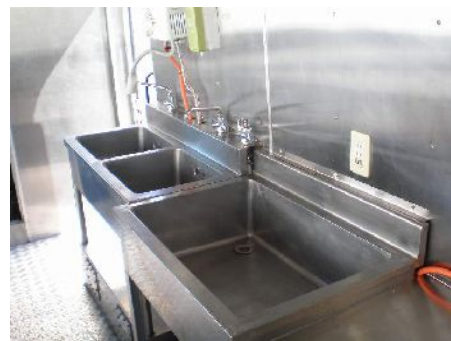
2層シンク、1層大シンク
