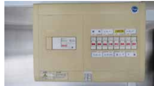
分電盤(配電盤)
